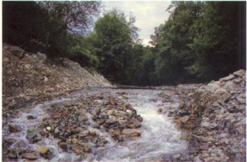
DEMOLICIÓN DE LA PRESA DE TREFILERÍAS EN EL RÍO GÁNDARA, CUENCA DEL ASÓN. LA ELIMINACIÓN DE OBSTÁCULOS ILEGALES Y FUERA DE USO AYUDA A AUMENTAR EL ÁREA ACCESIBLE AL SALMÓN Y A OTRAS ESPECIES MIGRADORAS.
